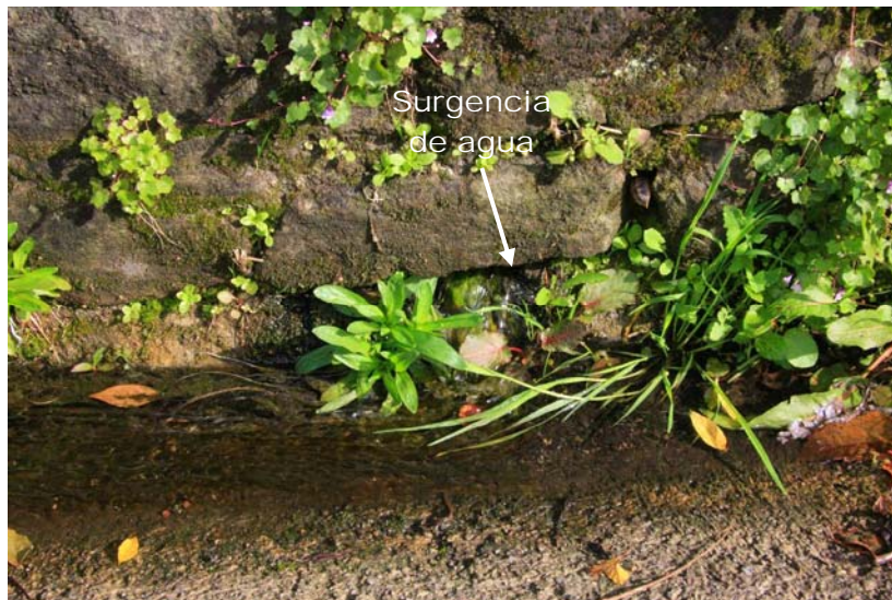
Foto 2. Surgencia de agua que se observa en la base del muro (8-10-2008).
